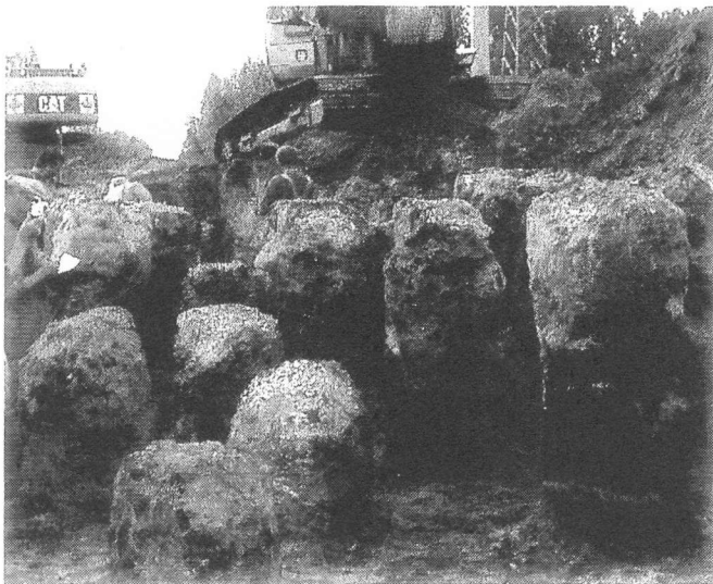
Bild 8: Freigelegte TVSS unterschiedlicher Ausbildung
