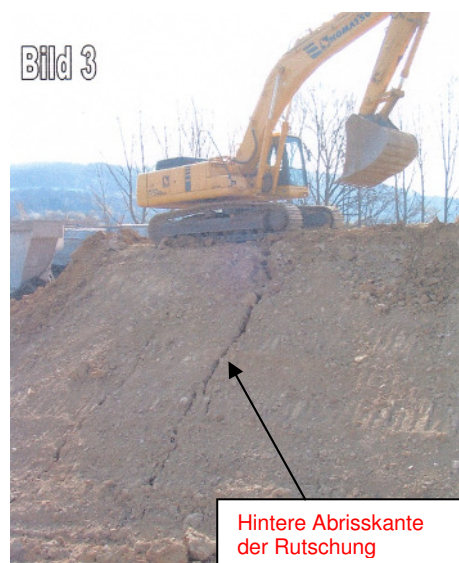
Abb. 39: Abrisskante in WL-Hinterfüllung tiefreich. Rutschung ins Tertiär
