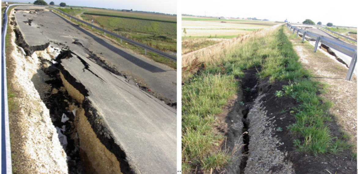
Abb. 1: Schadensbild beim 2. Geländbruch
