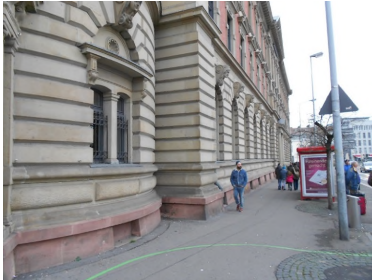
Hauptgebäude mit Ecktürmen (Ansicht vom Bahnhofplatz aus), am Verlauf der Fensterbrüstungen im Erdgeschoss optisch erkennbar zunehmende Setzung zu den Ecktürmen hin
